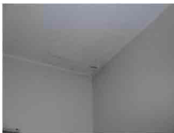
Foto 11 - Lotto 1 - Solaio (macchie di umido)
