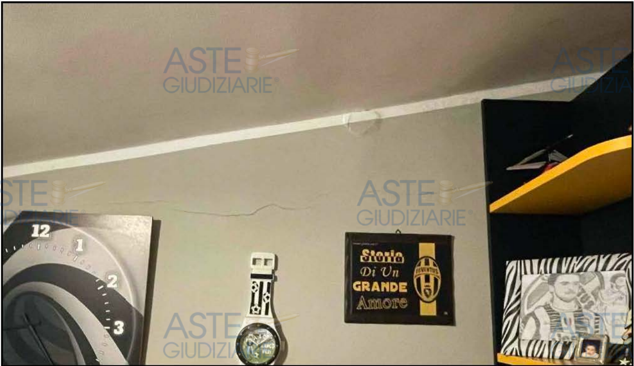
Lesione da distacco tra muratura di tamponamento e trave del tetto in conglomerato cementizio armato
