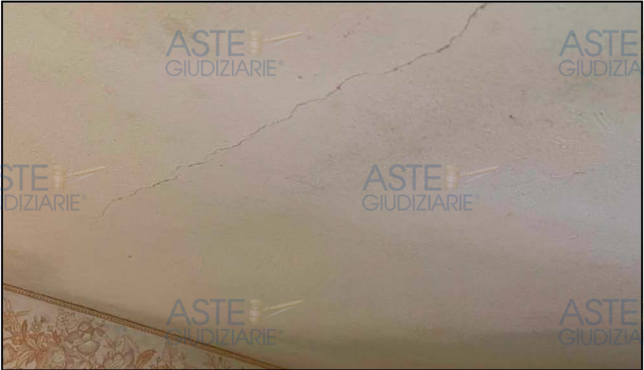
Lesione da distacco del copriferro delle armature dei travetti
