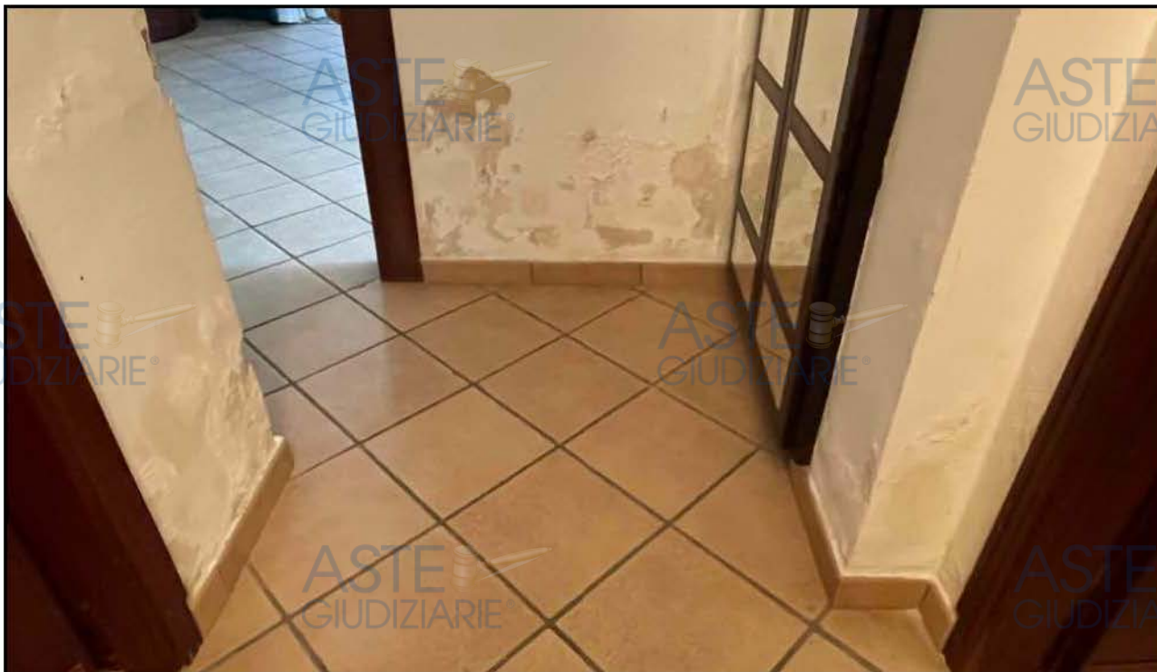
Umidità di risalita nelle pareti del corridoio di piano terra
