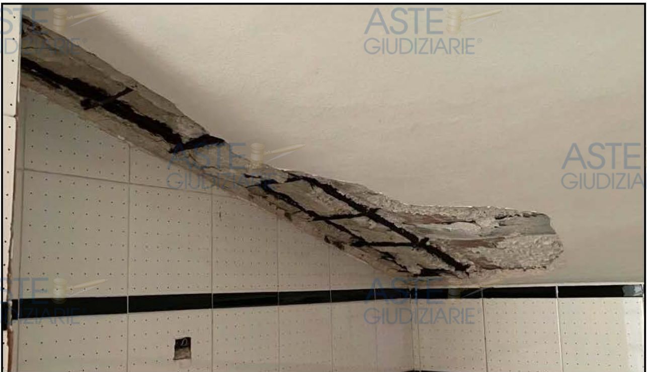
Ossidazione delle armature e completo distacco del copriferro
