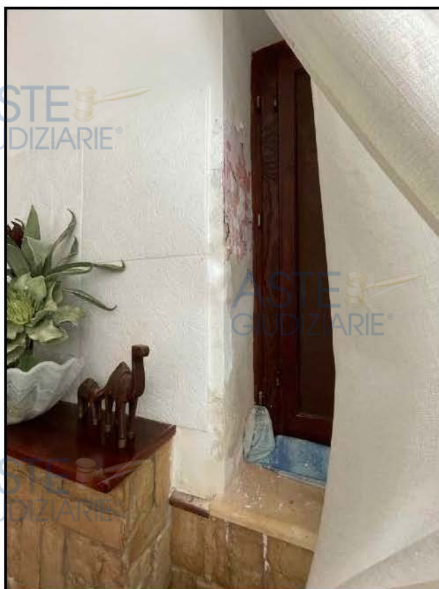
Umidità sul paramento interno del salone a piano terra
