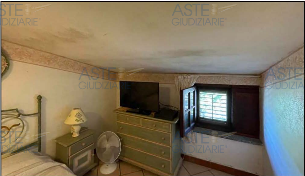
Umidità sull'intradosso del solaio di copertura con zone di distacco del copriferro dei travetti
