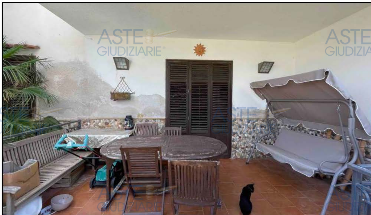
Umidità sul paramento esterno della parete del salone al di sotto del portico
