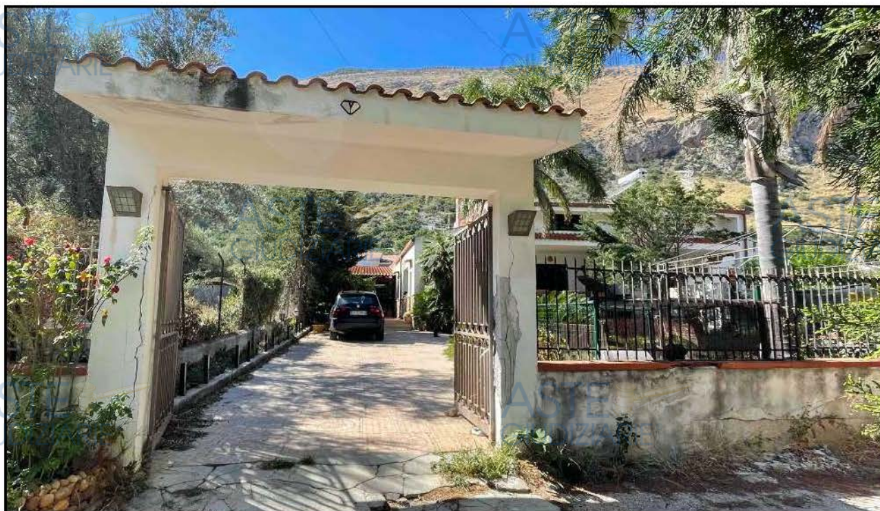
Lesioni per carbonatazione del calcestruzzo e ossidazione delle barre di armatura dei pilastri Macchie e scrostamenti di intonaco per umidità di risalita sul muretto di confine
