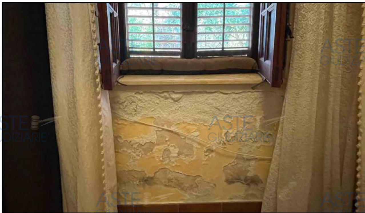
Umidità al di sotto del davanzale della parete esterna della camera da letto di piano terra
