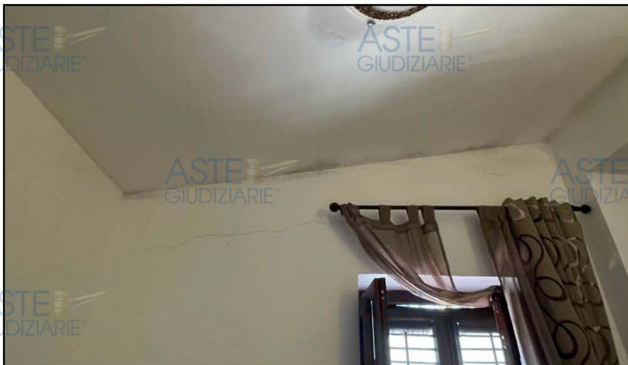
Muffe e lesione da distacco tra muratura di tamponamento e trave del tetto in conglomerato cementizio armato
