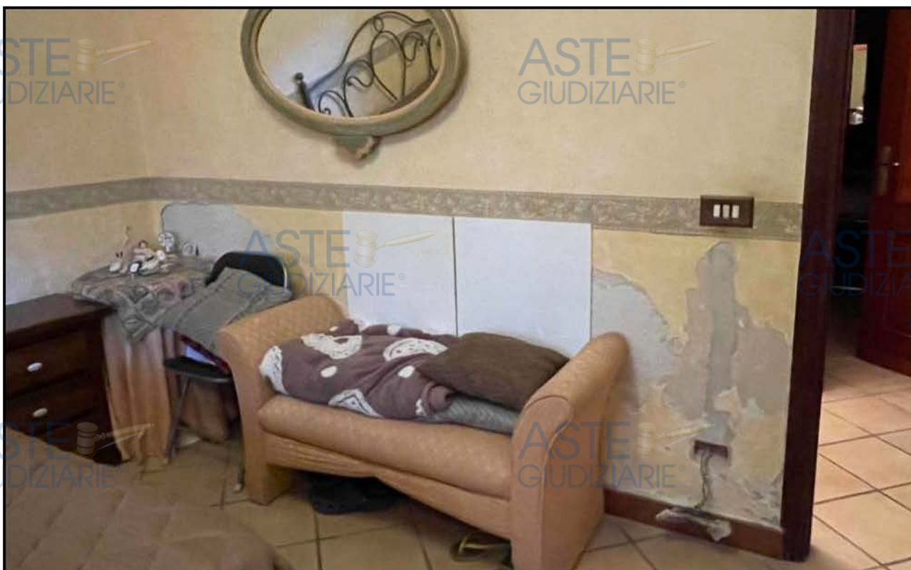
Umidità di risalita in una parete interna della camera da letto di piano terra
