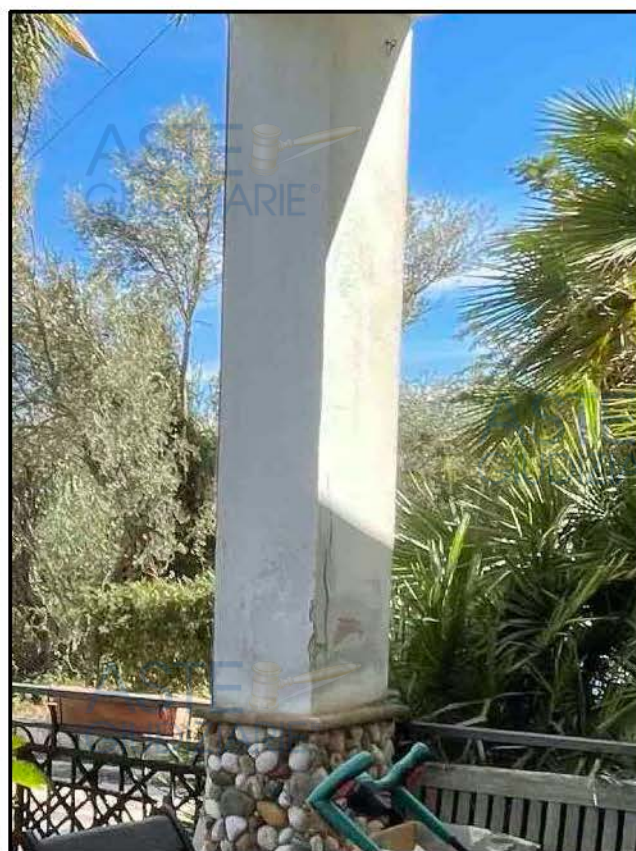
Lesione per ossidazione delle barre di armatura del pilastro del portico
