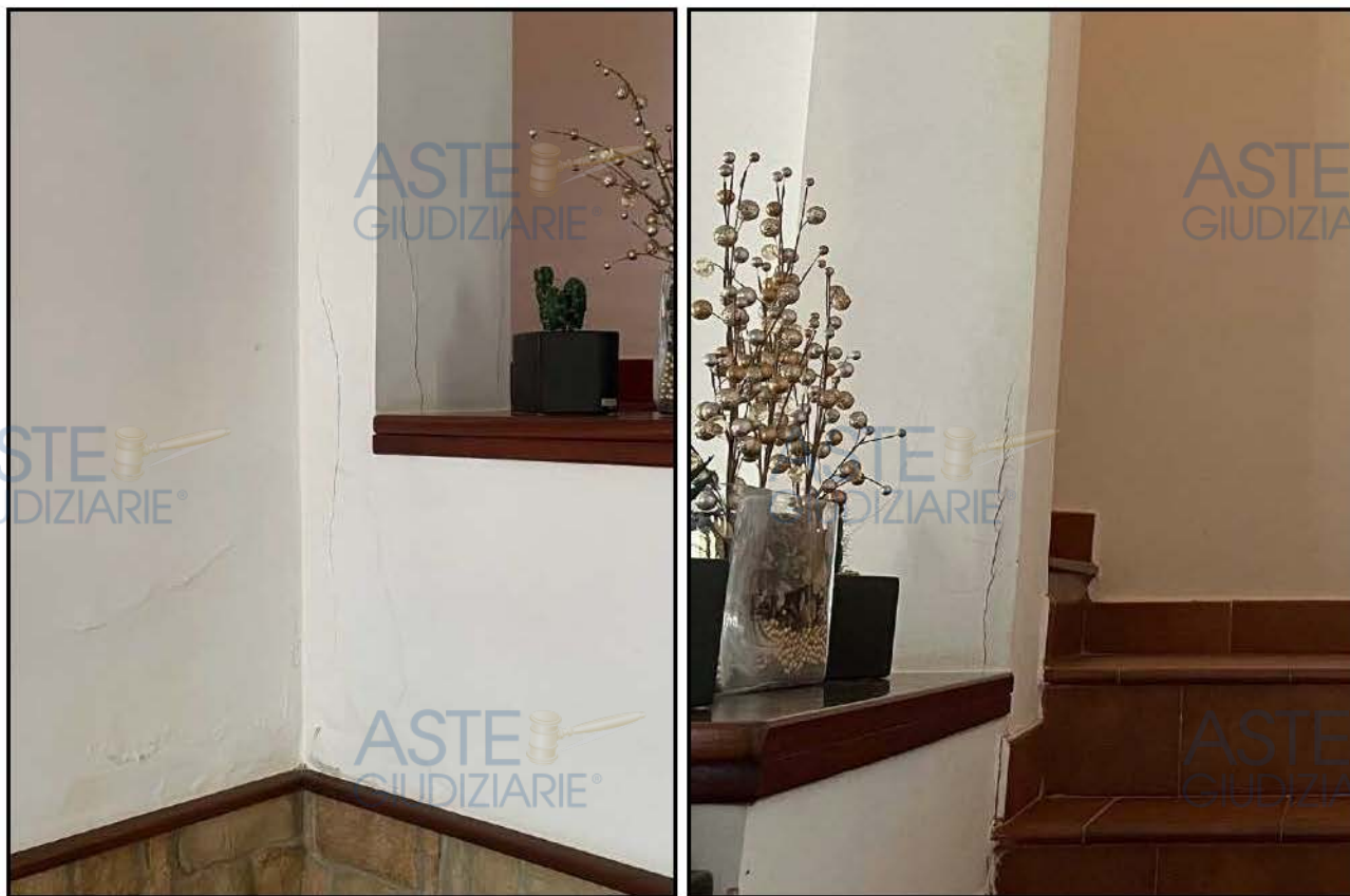
Lesione per ossidazione delle barre di armatura del pilastro della scala
