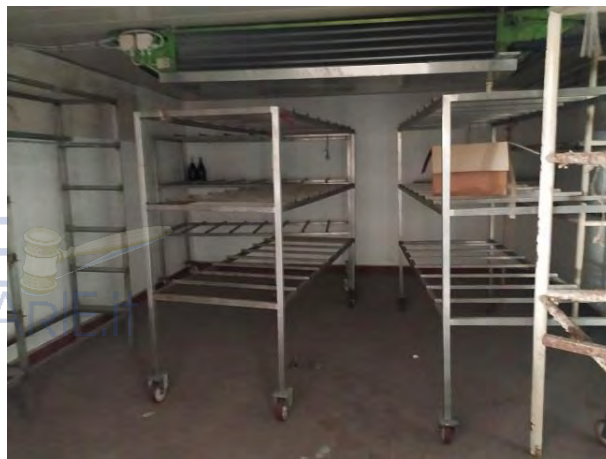
Interno della cella frigorifera
